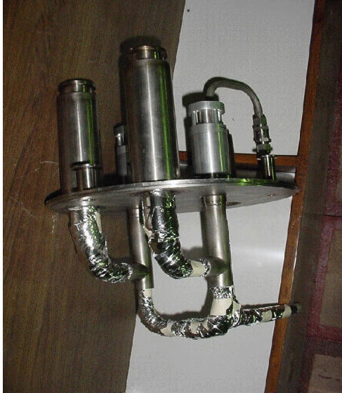
Fig. 3 : Inside of LN2 Valve box
